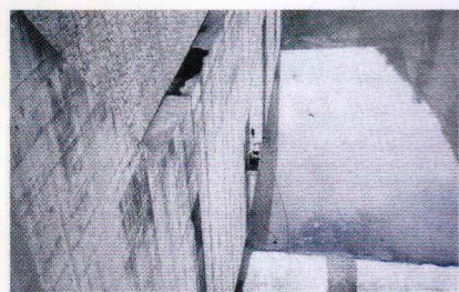
20tクレーン車でゴンドラを 吊り下げ、側壁面の止水工事 作業状況
