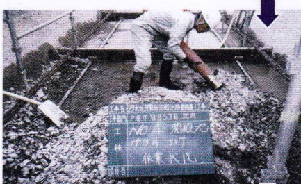
研り後 発生ガラ処理作業状況 (特殊強力吸引車10t 使用)
