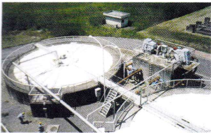
汚泥濃縮槽施設全景
