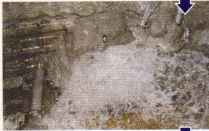
立坑の底板部浸入水
