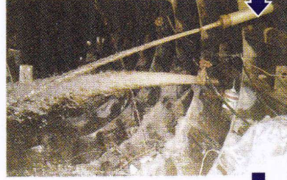
坑内到達坑付近浸入水
